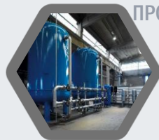
СИСТЕМЫ ОЧИСТКИ ПРОМЫШЛЕННЫХ СТОЧНЫХ ВОД (ИЭМЗ КУПОЛ)
