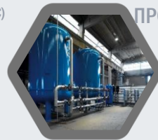
СИСТЕМЫ ОЧИСТКИ ПРОМЫШЛЕННЫХ СТОЧНЫХ ВОД (ИЭМЗ КУПОЛ)
