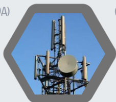
КОМПЛЕКС ОБОРУДОВАНИЯ РЕПИТЕРОВ (ИЖЕВСКИЙ РАДИОЗАВОД)
